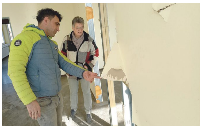
Defekte Wand: Bauamtsleiterin Beate Freimann und Sulayman Ahmad von der Entrümpelungsfirma schauen sich das an.
