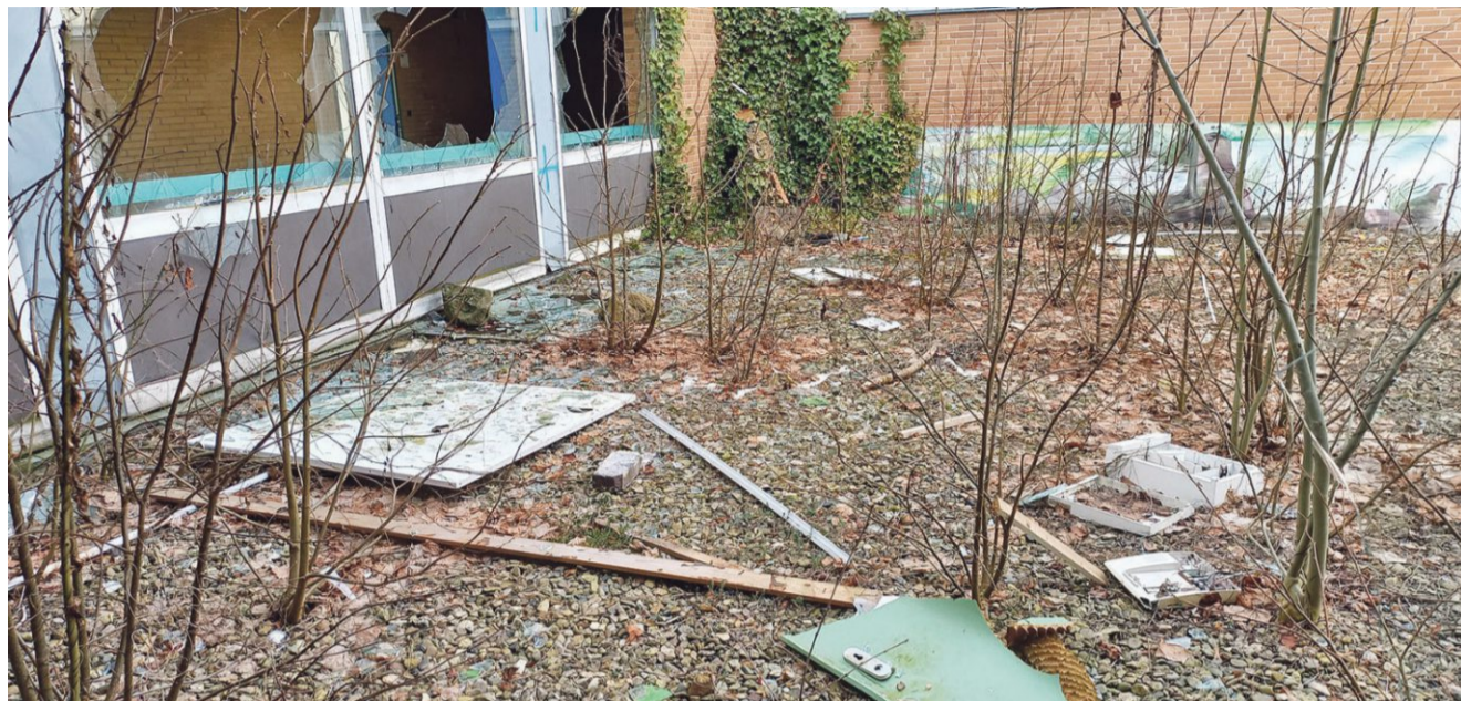
Zerstörte Scheiben und Trümmer im Innenhof: So sieht es derzeit bei der ehemaligen Krüger-Adorno-Schule aus. FOTOS: KUHLEMANN
